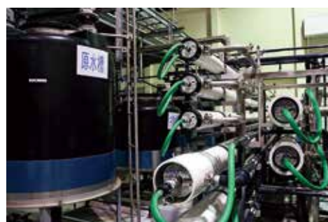
海洋深層水 RO ユニット。海水から淡水を濾し出す。
