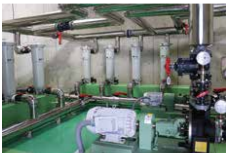
取水棟・送水棟にあるポンプ施設
