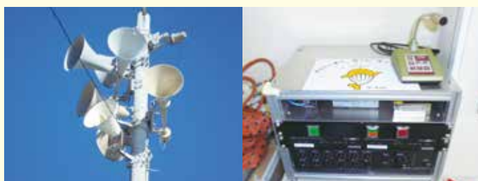
古江町：放送設備
