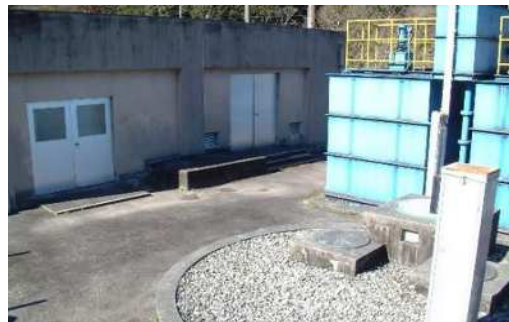
賀田第1(南)浄水場
