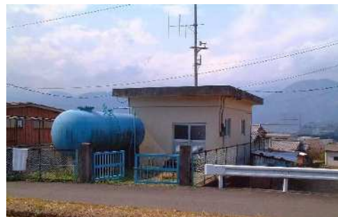
向井加圧ポンプ場
