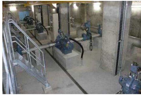
送配水ポンプ
