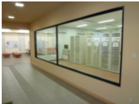
地震・津波観測監視システム （DONET）陸上局
