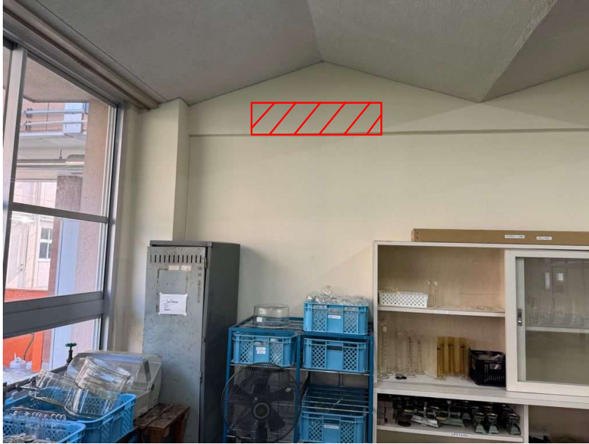
空調機取付予定位置
